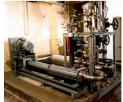
Lasitteen/veden pumppaaminen säiliöistä
